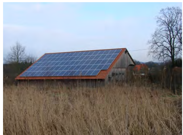
Das südwestlich ausgerichtete Remisendach trägt den Hauptteil der PV-Module
